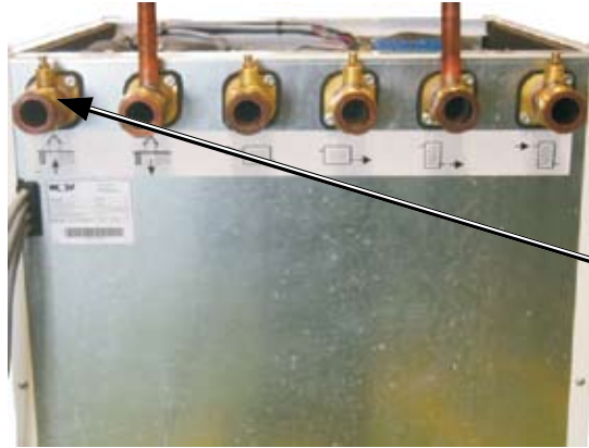
Handentlüfter im Sole-Eintritt
